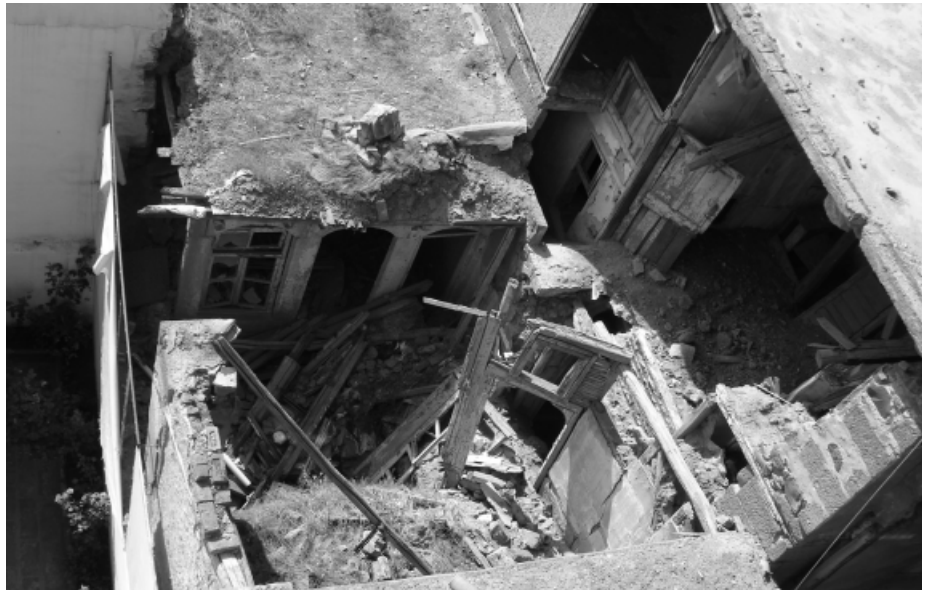
Ein zerstörtes Haus
